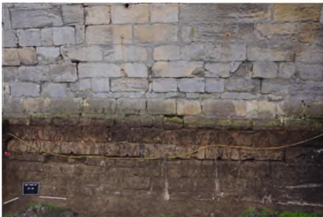
Vue générale du parement du mur-gouttereau US 1026 et de son talus US 1009
