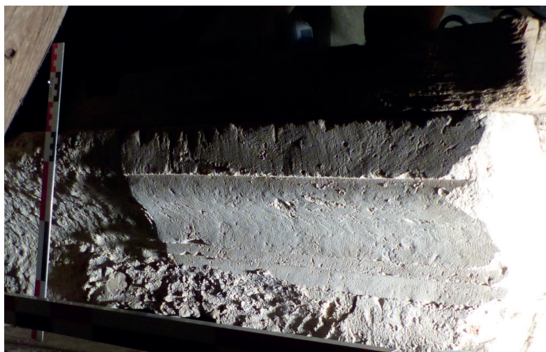
Détail d'un bloc de la corniche visible dans les combles ; on remarque les traces de brette
