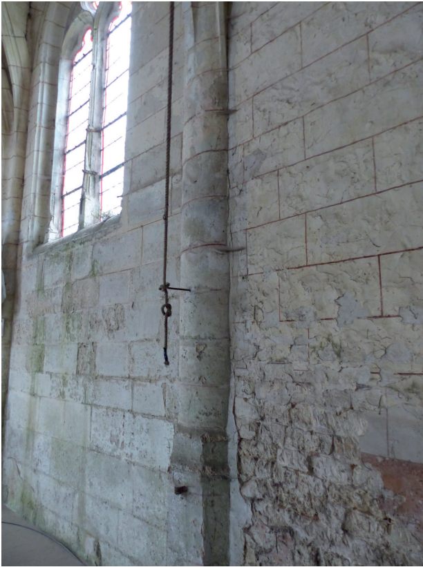
Détail du décor à faux-joints rouges de l'église, notez les ruptures dans le décor
