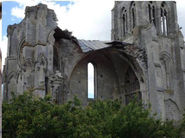
Le 21 juin après effondrement
